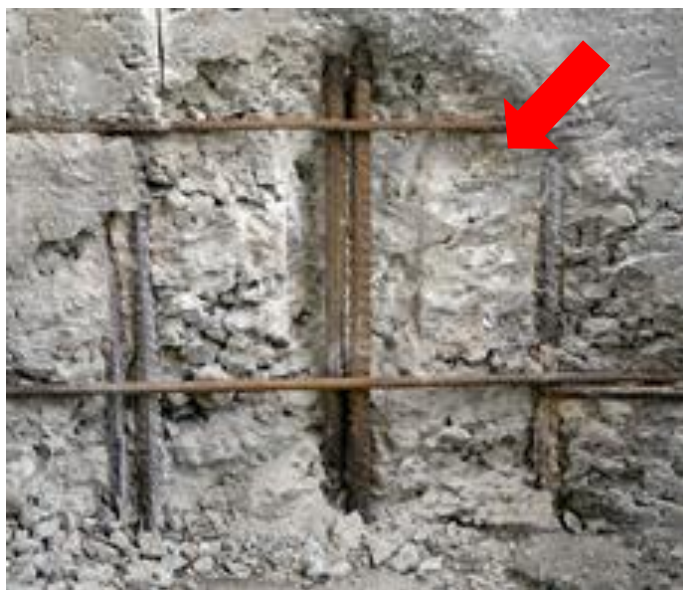
Figura 3 – Armadura exposta após concretagem
