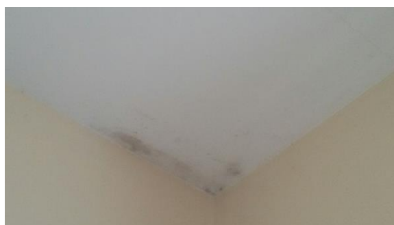
Figura 23 – Bolor em forro de gesso
