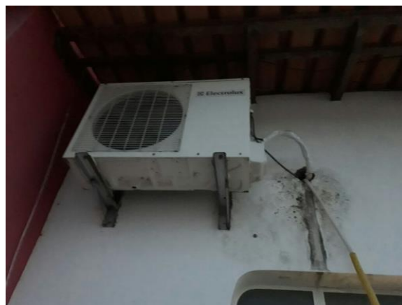
Figura 10 – Parede externa com manchas de infiltração e bolor. Fonte: SOUZA, A. S. (2018)
