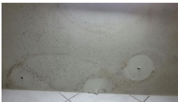
Figura 26 – Manchas de infiltração e bolor Fonte: SOUZA, A. S. (2018)
