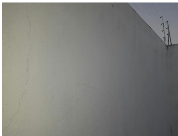
Figura 2 - Problemas devido a umidade Fonte: SOUZA, A. S. (2018)
