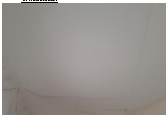
Figura 15 – Fissuras em forro de gesso Fonte: SOUZA, A. S. (2018)
