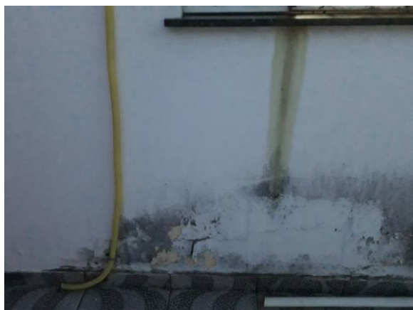
Figura 9 – Paredes externa com manchas de infiltração; bolor e descolamento da pintura. Fonte: SOUZA, A. S. (2018)
