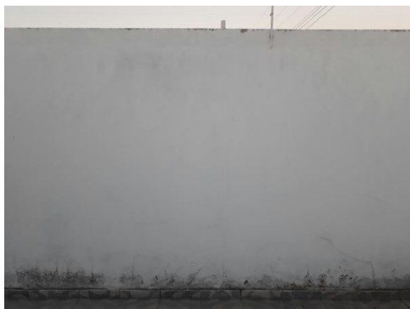
Figura 1 - Problemas devido a umidade Fonte: SOUZA, A. S. (2018)
