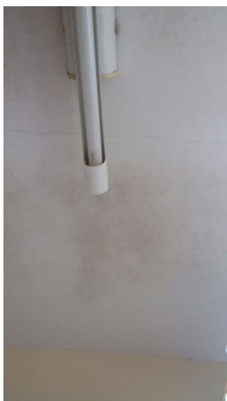
Figura 17 – Presença de fissura e bolor Fonte: SOUZA, A. S. (2018)
