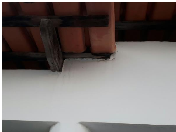
Figura 4 – Manchas de infiltração Fonte: SOUZA, A. S. (2018)
