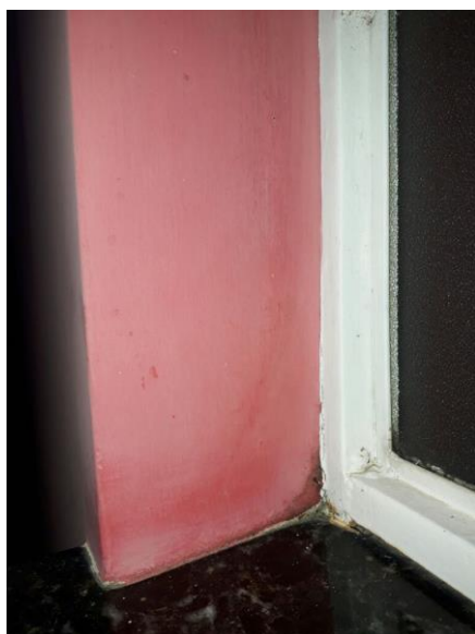
Figura 6 – Manchas de infiltração Fonte: SOUZA, A. S. (2018)
