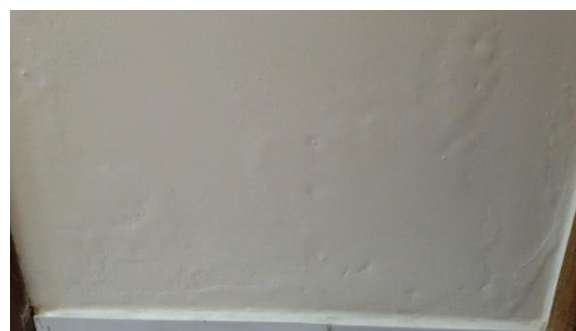
Figura 25 – Manchas de umidade Fonte: SOUZA, A. S. (2018)
