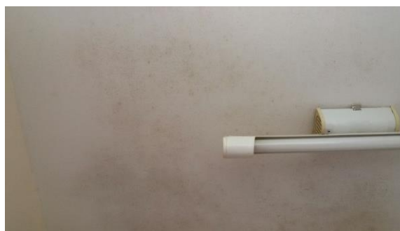
Figura 18 – Presença de fissura e bolor Fonte: SOUZA, A. S. (2018)
