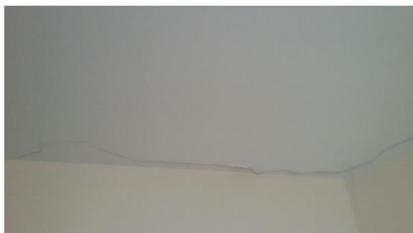
Figura 19 – Fissura em forro de gesso Fonte: SOUZA, A. S. (2018)
