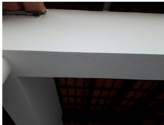
Figura 5 – Manchas de infiltração Fonte: SOUZA, A. S. (2018)
