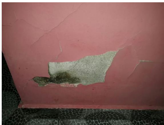
Figura 8 – Descolamento da camada de reboco x pintura Fonte: SOUZA, A. S. (2018)
