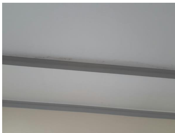
Figura 14 – Presença de mofo/bolor em região do forro Fonte: SOUZA, A. S. (2018)
