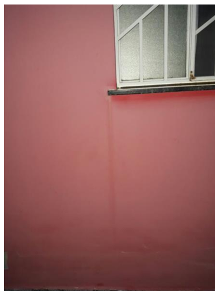
Figura 7 – Manchas de infiltração Fonte: SOUZA, A. S. (2018)
