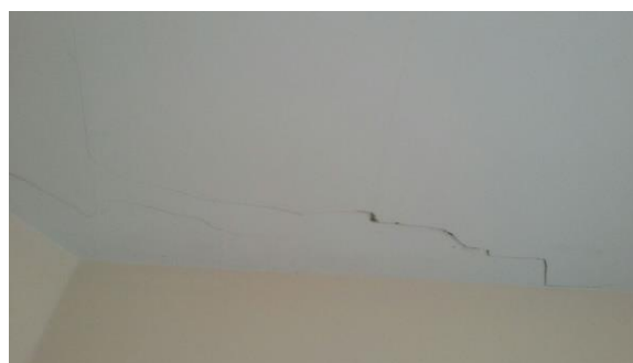
Figura 22 – Fissura em forro de gesso Fonte: SOUZA, A. S. (2018)
