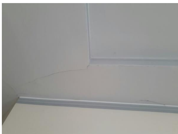
Figura 13 – Fissuras em forro de teto em gesso da sala de estar
