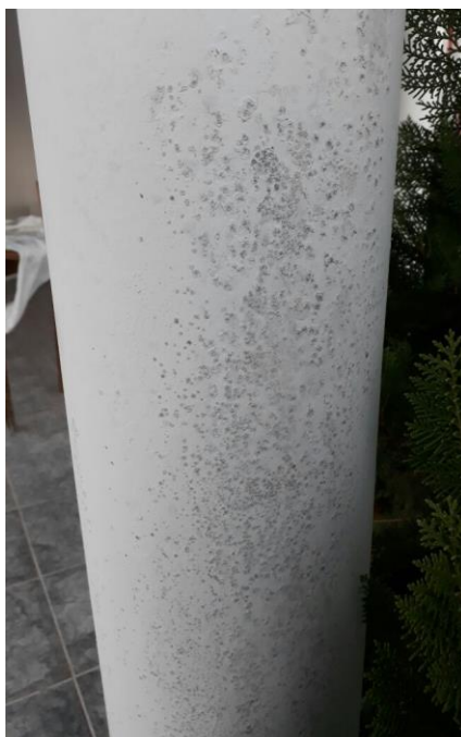
Figura 3 – Pilar da varanda com presença de bolor umidade
