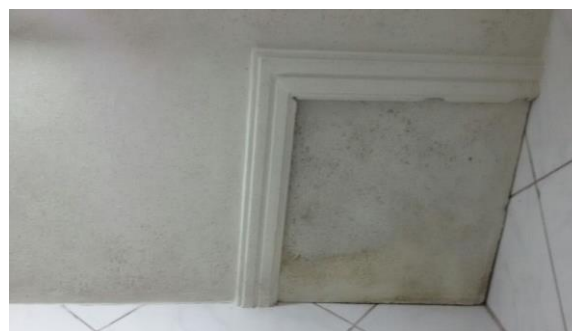
Figura 27 – Manchas de infiltração e bolor Fonte: SOUZA, A. S. (2018)
