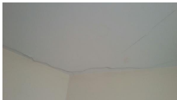
Figura 20 – Fissura em forro de gesso Fonte: SOUZA, A. S. (2018)
