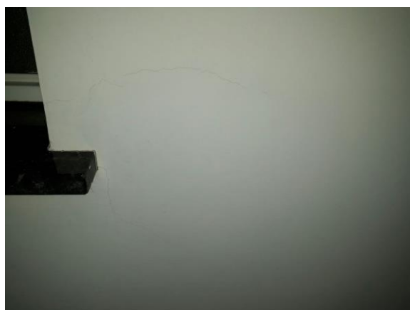
Figura 11 – Fissuras em alvenaria devido à compressão Fonte: SOUZA, A. S. (2018)
